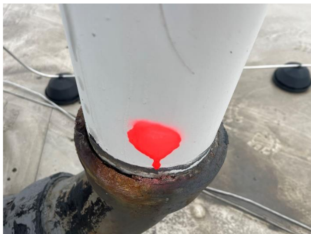
Obr. /26/ Degradace pojistného tmelu (prostupy)
