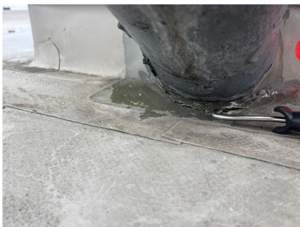
Obr. /29/ Degradace pojistného tmelu (prostupy)
