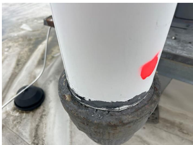
Obr. /24/ Degradace pojistného tmelu (prostupy)
