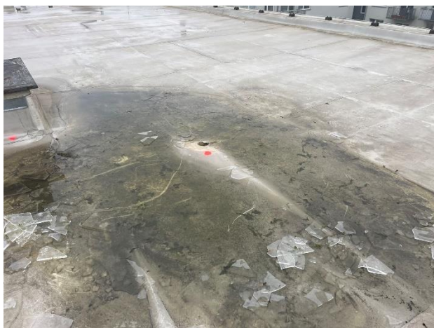
Obr. /21/ Netěsnost napojení vpusti na svod
