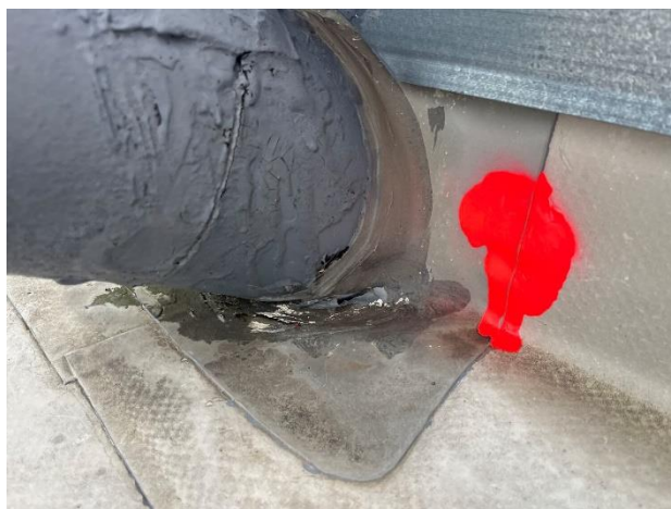
Obr. /28/ Degradace pojistného tmelu (prostupy)
