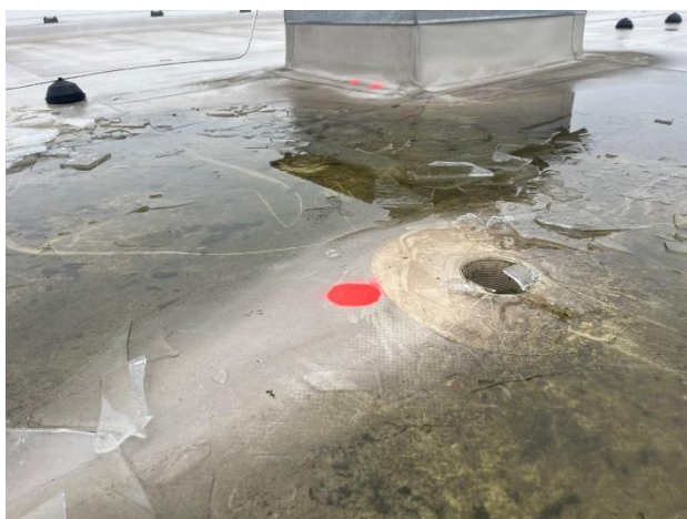
Obr. /23/ Netěsnost napojení vpusti na svod
