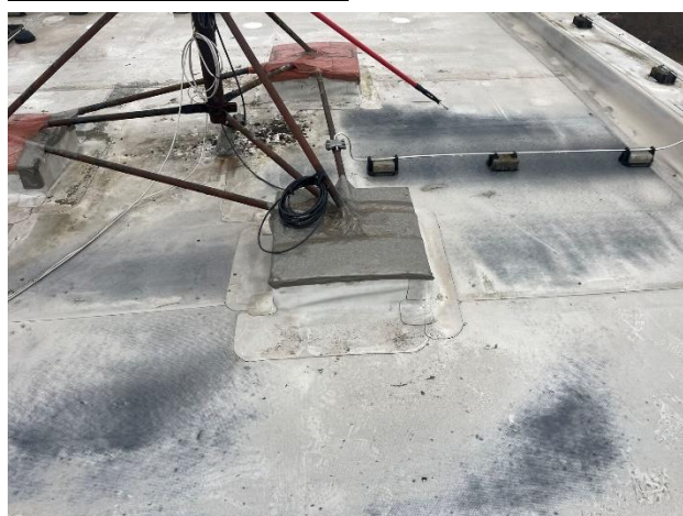
Obr. /15/ Degradace hydroizolační fólie
