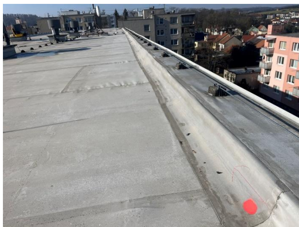
Obr. /18/ Degradace hydroizolační fólie
