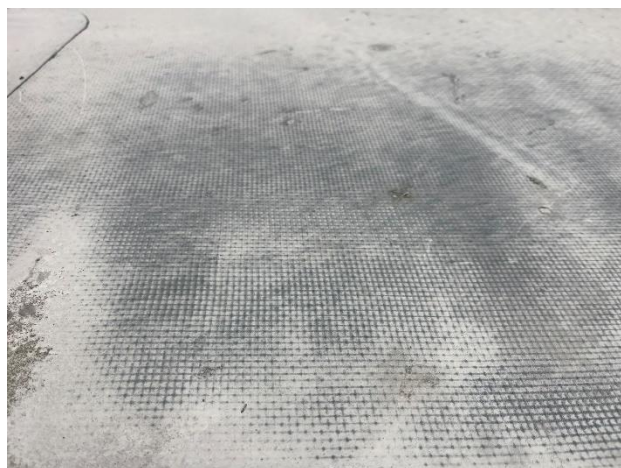
Obr. /17/ Degradace hydroizolační fólie
