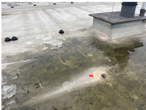
Obr. /22/ Netěsnost napojení vpusti na svod
