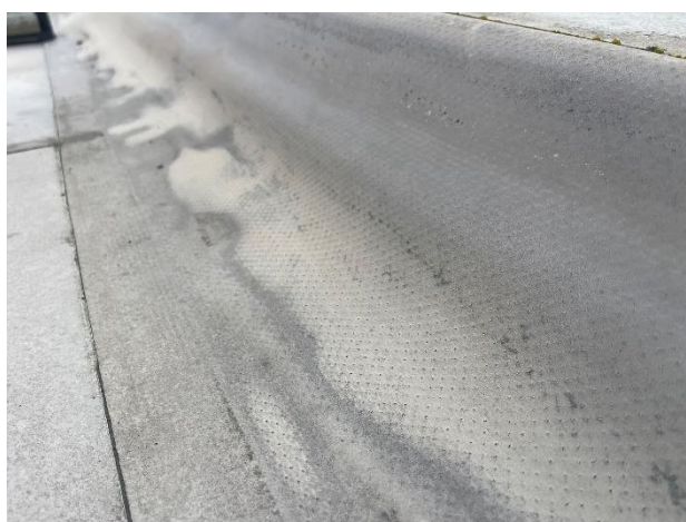
Obr. /16/ Degradace hydroizolační fólie
