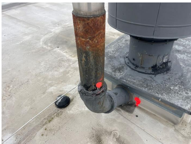
Obr. /27/ Degradace pojistného tmelu (prostupy)
